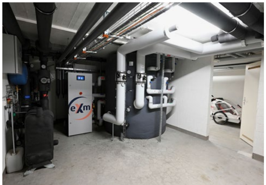
Blick in eine Energiezentrale mit Plattenwärmetauscher, Brauchwasser-Wärmepumpe und Warmwasserspeicher (von links). Nicht im Bild ist die Grundwasser-Wärmepumpe für die Raumwärme.
