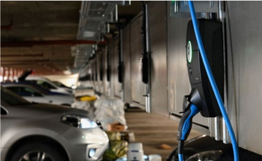
Die erste Ladestation in der Einstellhalle ist bereits montiert, 49 weitere können im Handumdrehen nachgerüstet werden.
